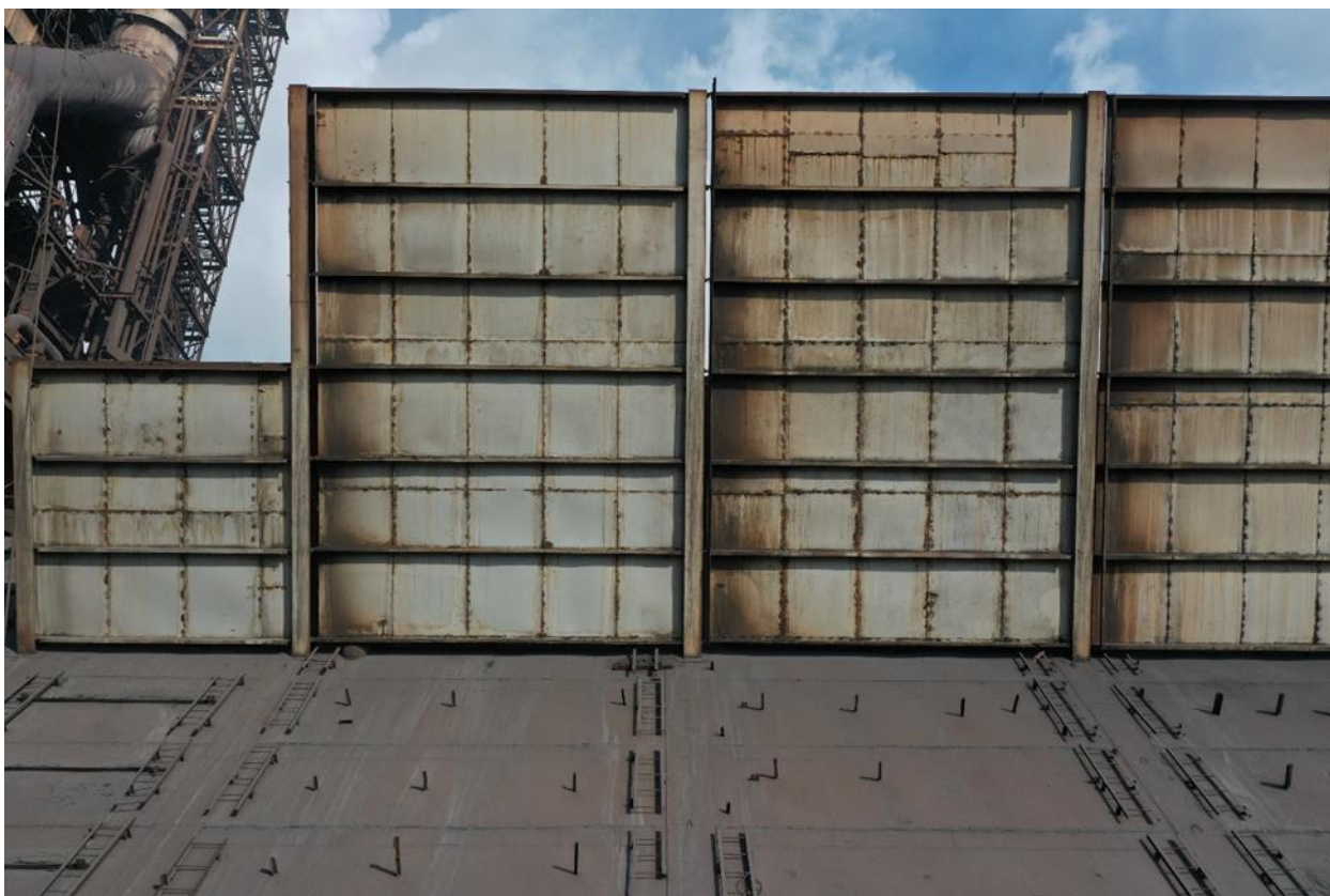
Рисунок 1 – Ветровое ограждение с отсутствующей секций
