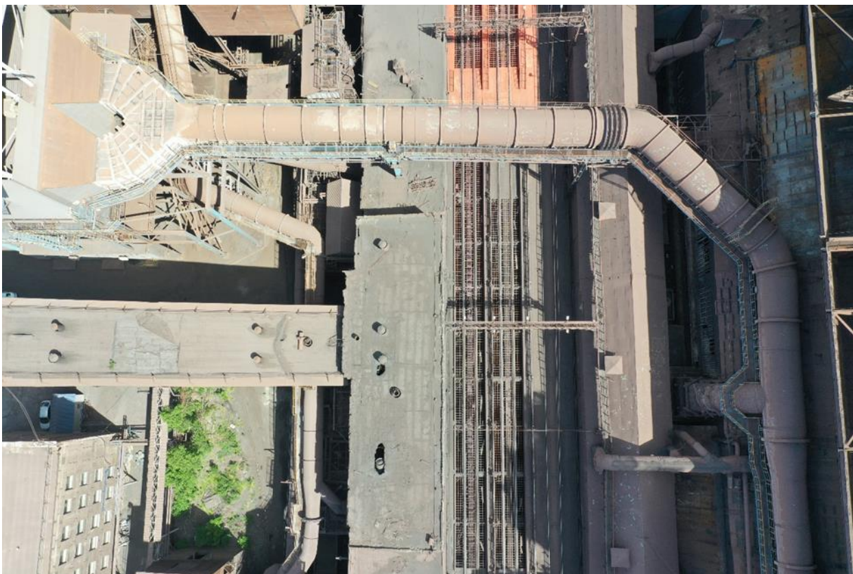
Рисунок 2 – Часть крыши сооружения с отсутствующими и повреждёнными вентиляционными дефлекторами
